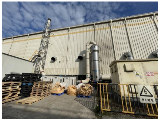
喷淋塔+动态汽水分离器+活性炭吸附装置
