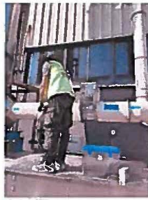
B6 熔喷车间废气 处理前
