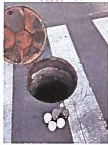
生活污水排放口
