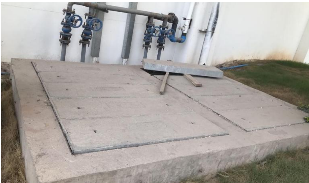
危险废物仓事故收集池
