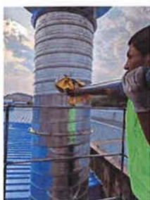
DA001 废气排放口
