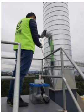
注塑、吹塑工序废气 排放口 DA001
