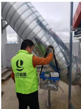
注塑、吹塑工序废气 处理前
